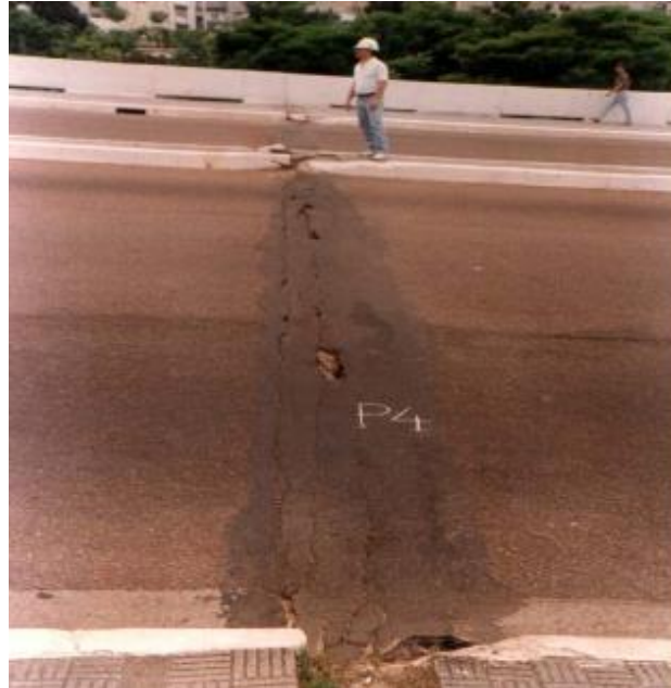
Figura 5 – Falha na pista de rolamento devido excesso de asfalto.
