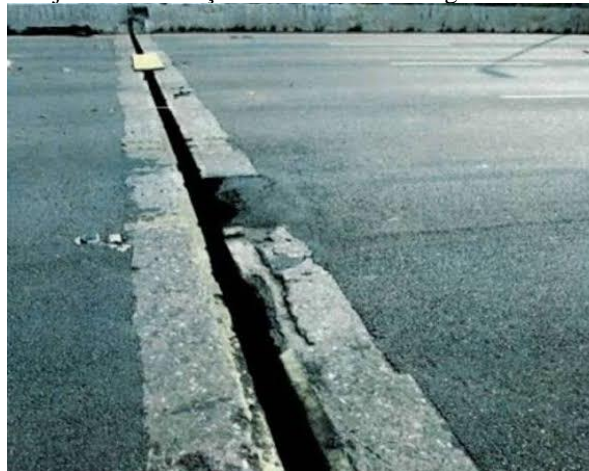
Figura 9 – Falhas na junta de dilatação no viaduto da Marginal Pinheiros em São Paulo (SP).
