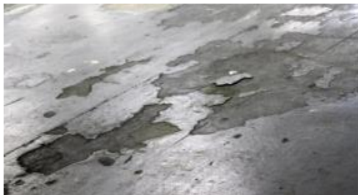
Figura 3 - Piso desgastado por abrasão.
