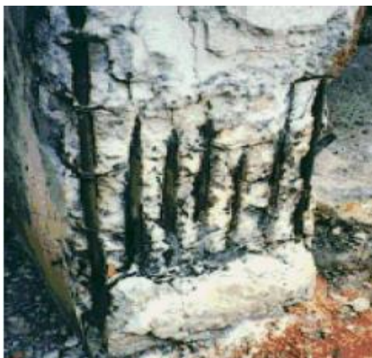
Figura 7 – Imagem corrosão da armadura em pilar.
