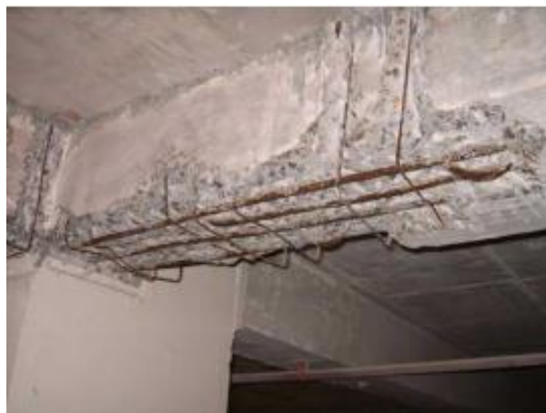
Figura 2 - Desagregação do concreto em viga.
