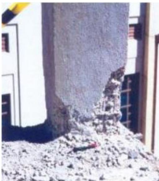
Figura 6 - Falhas de concretagem na base do pilar.
