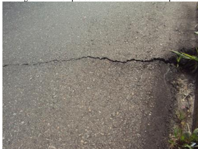
Figura 1 – Exemplo de fissura na cabeceira da pista.
