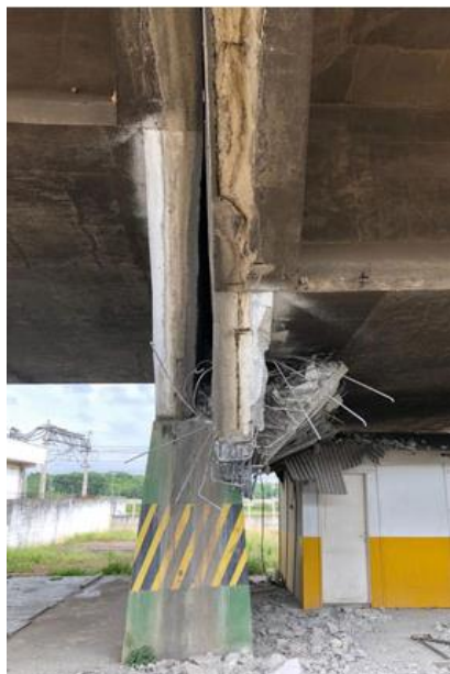
Figura 12 – Apoios danificados pelo deslocamento do tabuleiro na Marginal Pinheiros em São Paulo (SP).
